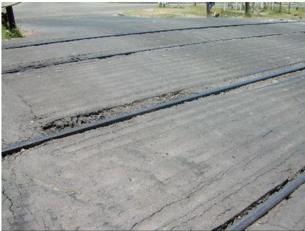
El estado del pavimento en el paso a nivel es regular
