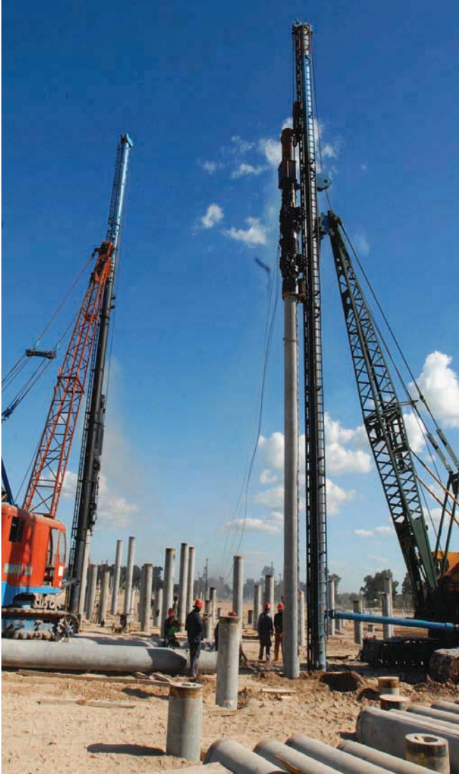
El Bosque de Pilotes. Se aprecian las piloterías en acción, hincando los pilotes del Módulo N°3.
