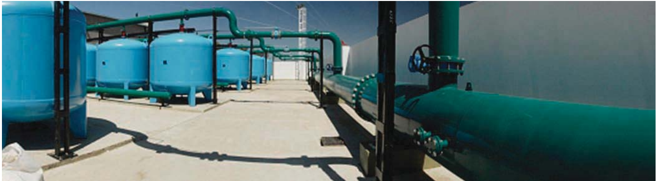
Planta Virrey del Pino. Ingreso de Agua cruda a la etapa de pretratamiento.
