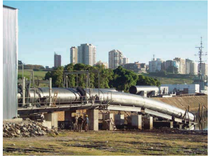
Emisario submarino. 3.300 metros de longitud y 2 m de diámetro. Underwater Outfall. 3,300 meters long and 2 meters in diameter.
