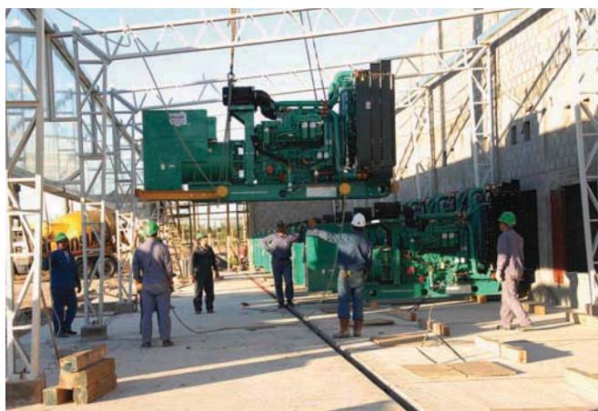
La Plata. Nueve centrales de generación eléctrica se pusieron en marcha en la provincia de Buenos Aires.
