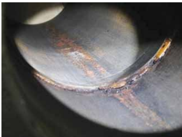
Figura 11. Banda longitudinal de corrosión.
